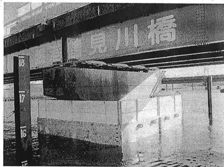
臨港鶴見川橋の工事では、1橋脚当たり補強が40日、仮締切設置・撤去が10日のサイクルで工事を進めた
