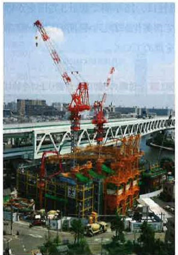
写真1 ■ 王子第2ポンプ所の建設でニューマチックケーソン工法を適用(写真:大豊建設)
