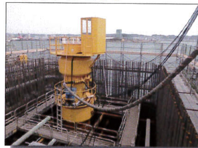
作業室から掘削土を出したり機械を出し入れするための設備です。
