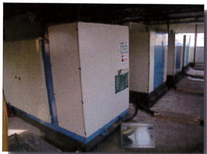
作業室に高い気圧の空気を送るために空気を圧縮する機械です。
