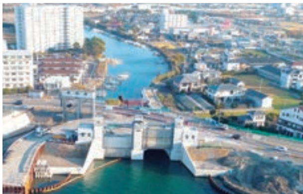
工事件名：平成28-30年度 榎瀬川水門新設工事 発注者：国土交通省 四国地方整備局
