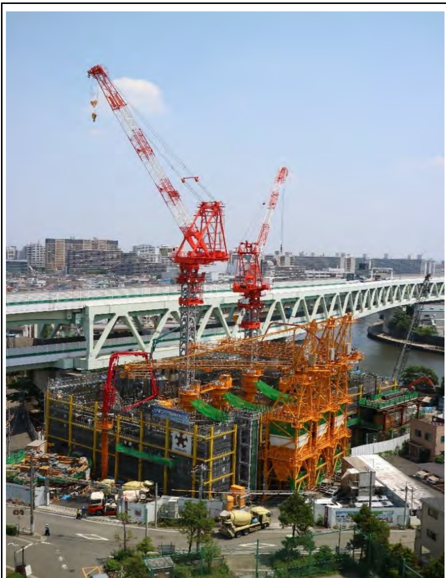
王子第二ポンプ所建設その2工事【東京都】 (ニューマチックケーソン工法)
