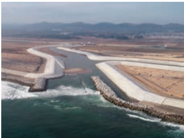
工事件名：平成26年度県債311地震災1441-A03号 坂元川外河川災害復旧工事(その3) 発注者：宮城県
