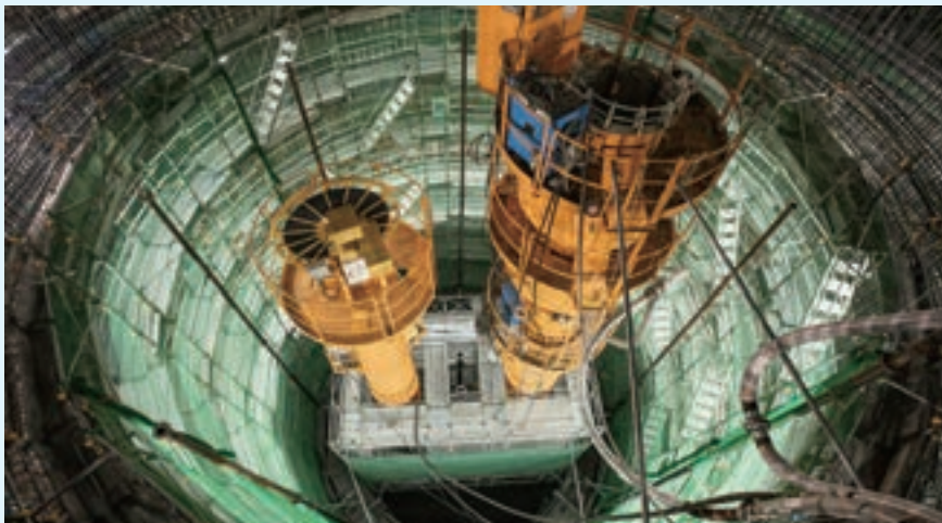
ニューマチックケーソン工法による、発進立坑(深さ41m,内径13m)の掘削
